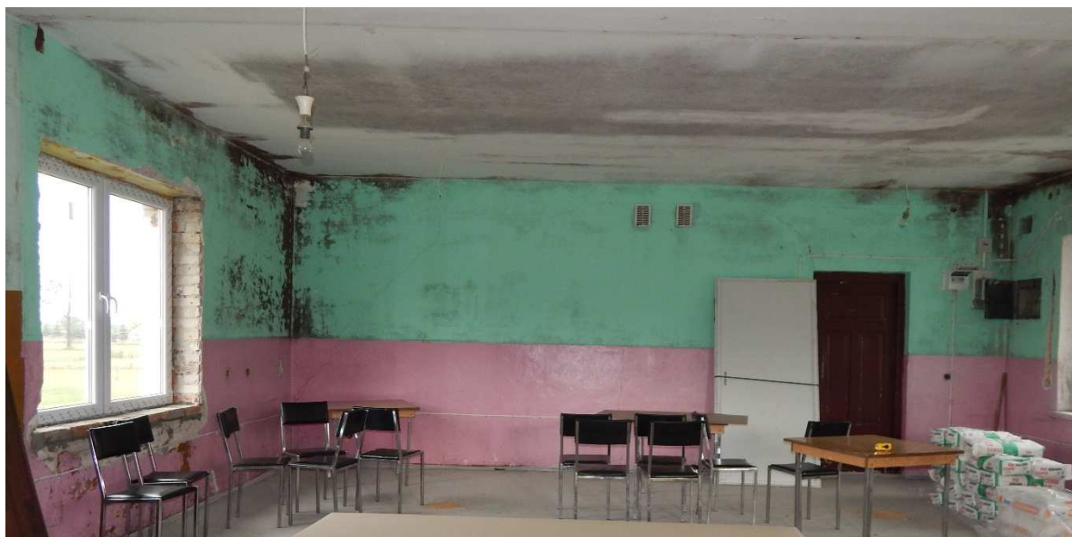
Zdjęcie nr 2 – stan ścian wewnątrz budynku
