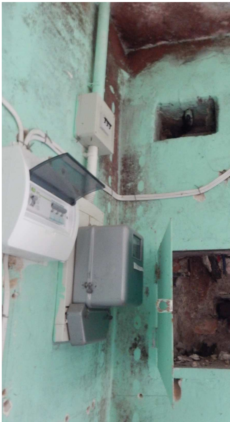
Zdjęcie nr 8 – istniejący układ pomiaru energii elektrycznej w budynku – do przeniesienia
