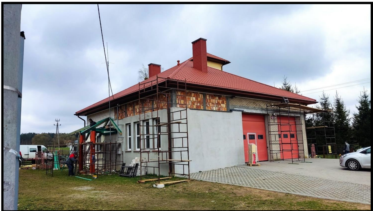
Ad. 5. Rozbudowa i termomodernizacja budynku Ochotniczej Straży Pożarnej w Czarnej Wsi Kościelnej – więźba dachowa i pokrycie dachu
