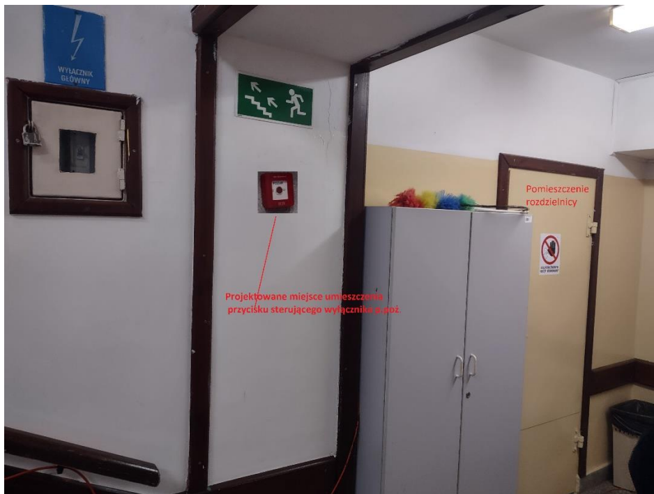
Rys. 2 Projektowane miejsce umieszczenia przycisku sterującego wyłącznika p.poż.
