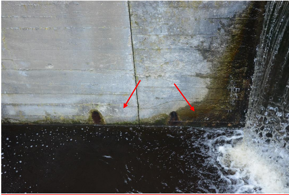
Fot.3, 4 – Lokalne wzmocnione przesiąkanie zachodniej części budowli od strony wody dolnej
