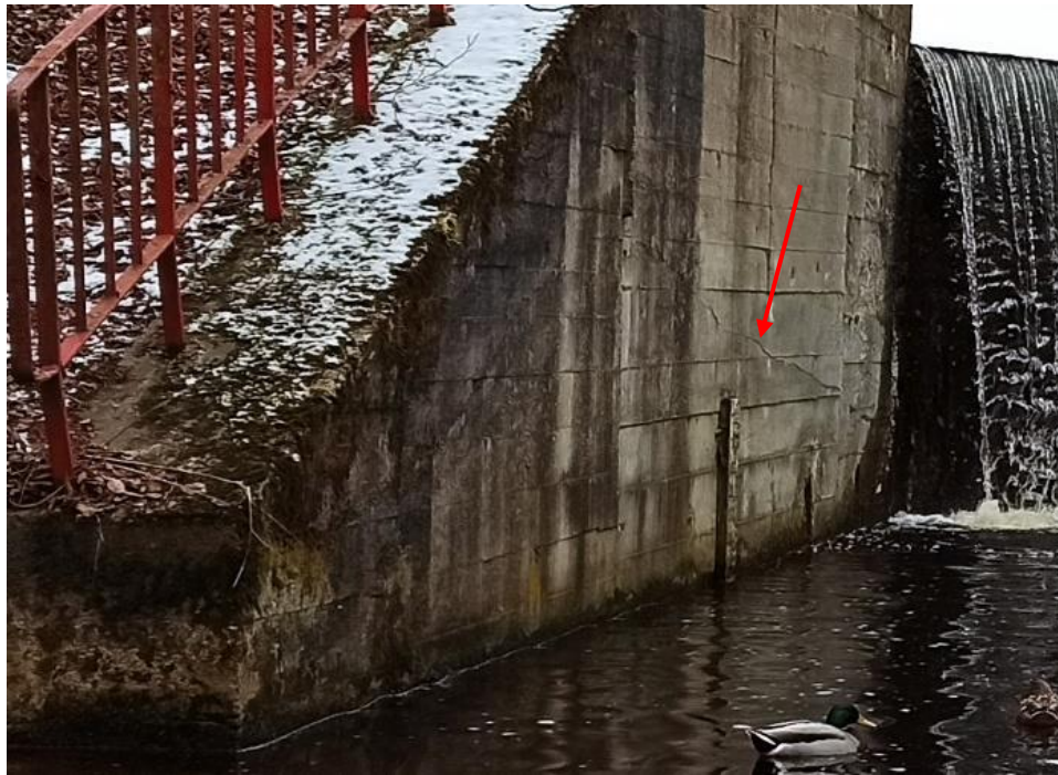
Fot.1, 2 – Spękania występujące na całej długości zachodniej części konstrukcji jazu od strony wody dolnej, widoczne przesiąki przez konstrukcję
