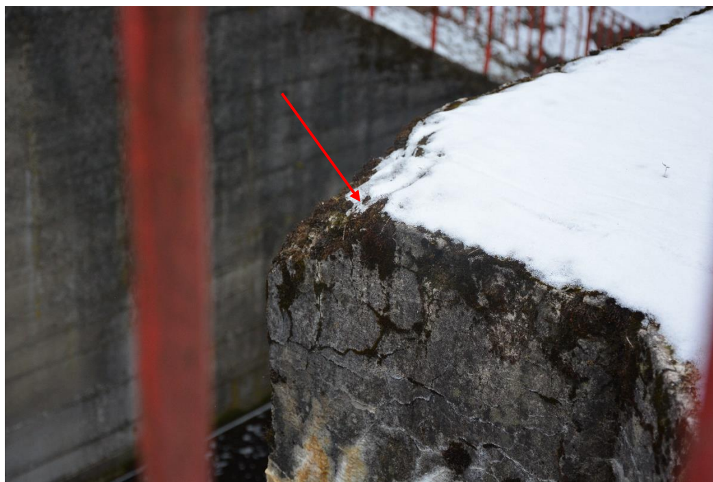
Fot.5, 6 – Ubytki powierzchniowe, występują na całej konstrukcji jazu piętrzącego
